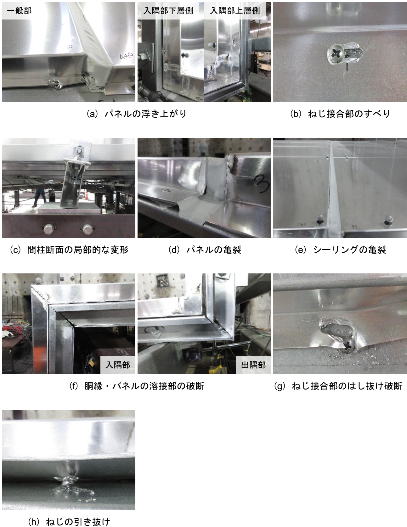
写真4.4 損傷状態の観察結果(試験体No.1)
