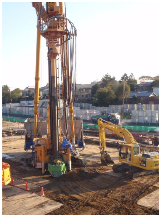
図 1.2.1.3 市街地におけるサンドコンパクションパイルの施工状況例
