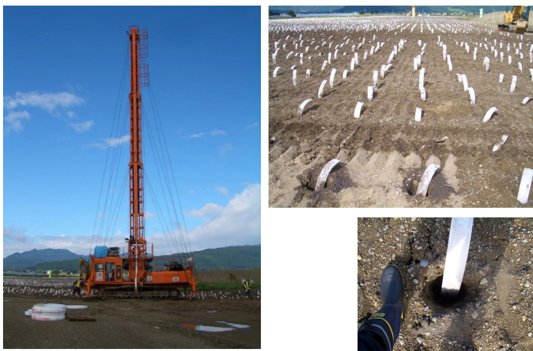
図 1.2.1.1 バーティカルドレーン（VD）工法の施工状況例 （プラスチックボードドレーン工法）
