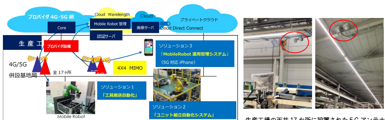
生産工場の天井 17 か所に設置された 5 G アンテナ
