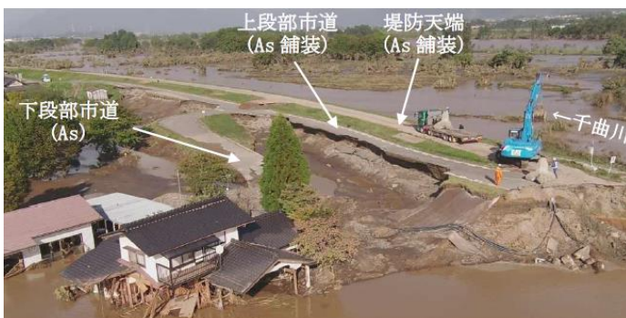
図 1.12 破堤部下流側 17)
