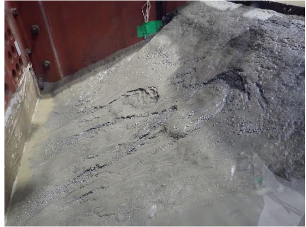
図 3.82 越水後の引水による川表のり面の変状
