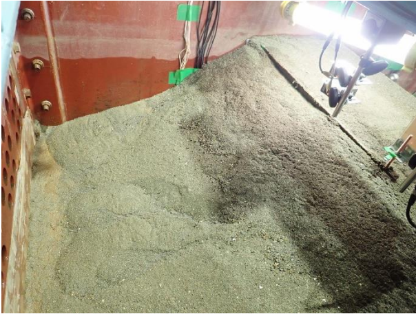
図 3.81 繰り返し浸透後の引水による川表のり面の変状
